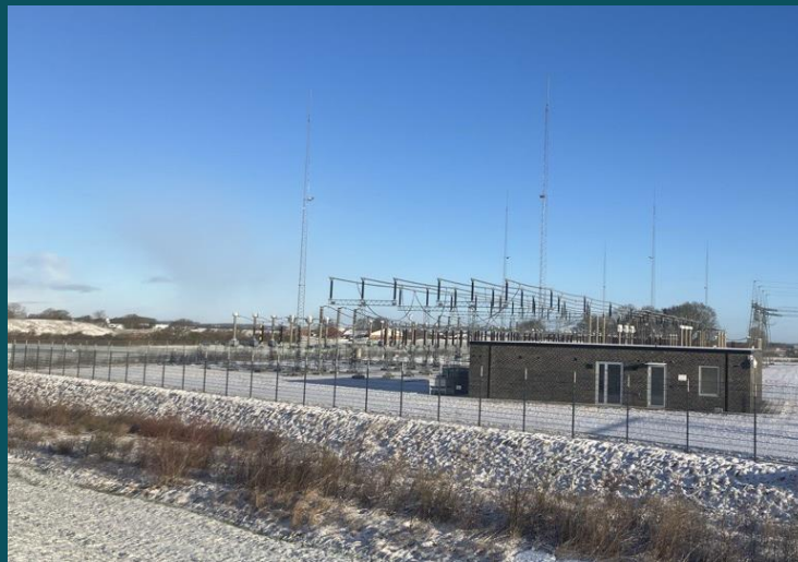
Eksempel: Energis 150 kV koblingsstation i Tårup.
